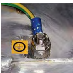
Miejsce podłączenia przewodu uziemienia
